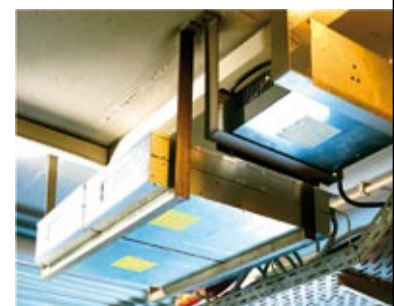
Induktionsgeneratoren RTCSmp der neuesten Generation, extern an die Kellerdecke verbaut.
