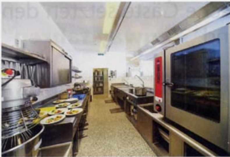
Vorbereitungsküche mit Induktionstechnik.
