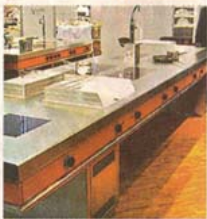
Großküche im Casinorestaurant Velden. Foto: FHE Franke
